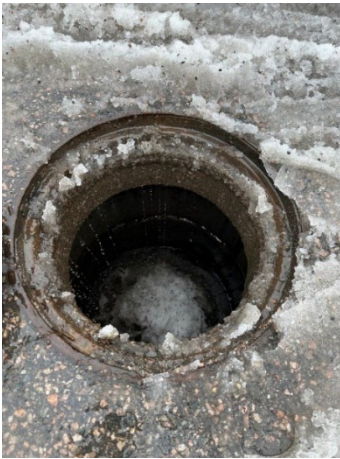
Kuva 1: Sadevesikaivo, joka kerää pihan hulevedet.
